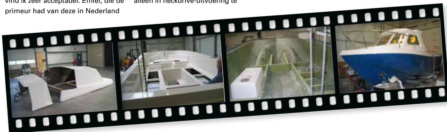
De 707 in aanbouw. Bij de lange kajuit van de Offshore 808 wordt een stuk tussenuit gehaald voor de kajuit van de 707.
